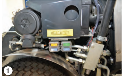
60 A JF15 Generator- 60 A JF1 Versorgungssicherungskasten 20 A JF2 Notfallleitung - 30 A JF3 Motorleistung
