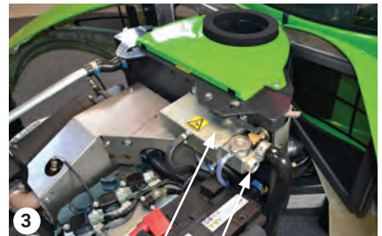
Ausgleichsbehälter - Kühlflüssigkeit kontrollieren
