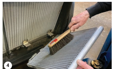
4 Verflüssiger der Klimaanlage
