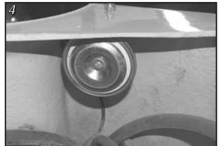
Stecker am Alarm prüfen
