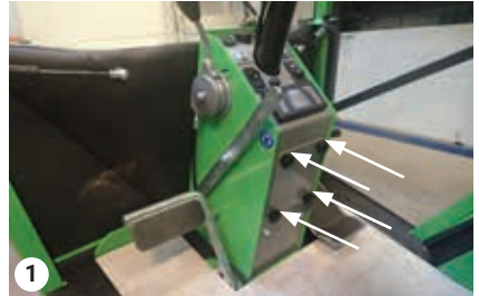
Sikringer i styrekolonne
