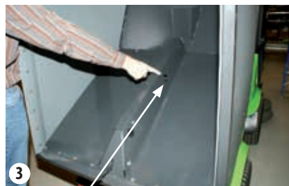
Plastprop ved inspektionshul
