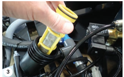
Rengør eller udskift filteret
