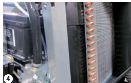
Limpie los radiadores con aire comprimido
