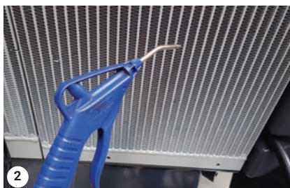
Aire comprimido Radiador
