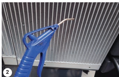
Aire comprimido Radiador
