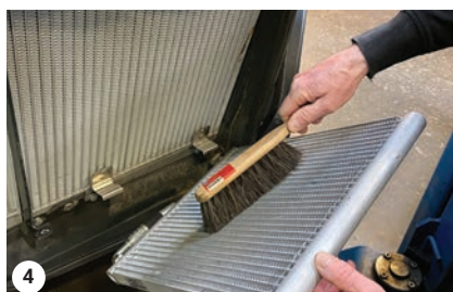
Condensador del aire acondicionado
