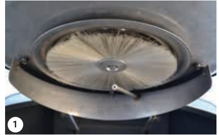
1 Comprobación del filtro rotativo y de la turbina
