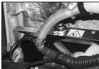
Remplissage du liquide de refroidissement
