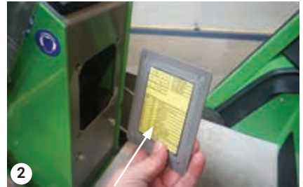
Vue d'ensemble des fusibles - Au dos du couvercle des fusibles
